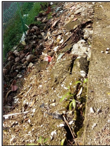
Gambarajah 5.9. Lubang pada rekahan bangunan
