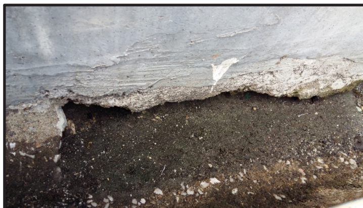
Gambarajah 5.10. Lubang pada rekahan bangunan
